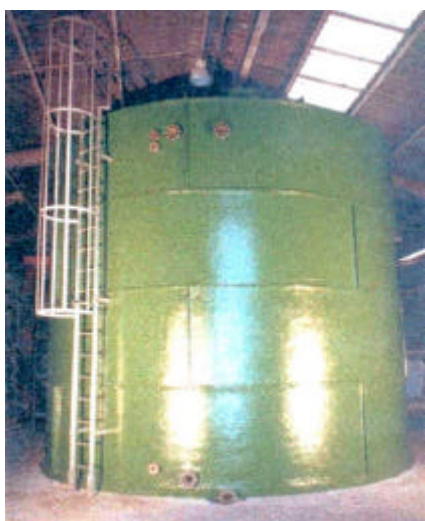
Stockage d'eau potable
